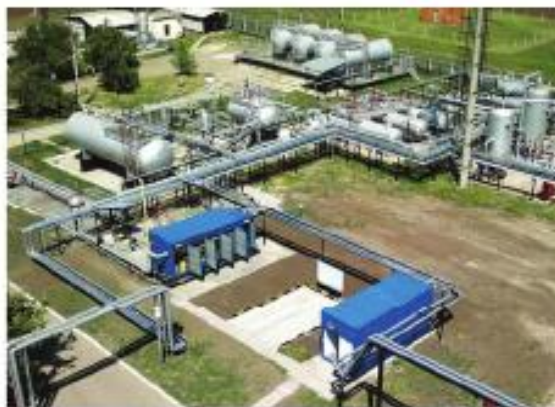
Рис. 2. Газовая винтовая станция SGVe 315-20/0,5-25 У1 на УКПНГ, Бельск
