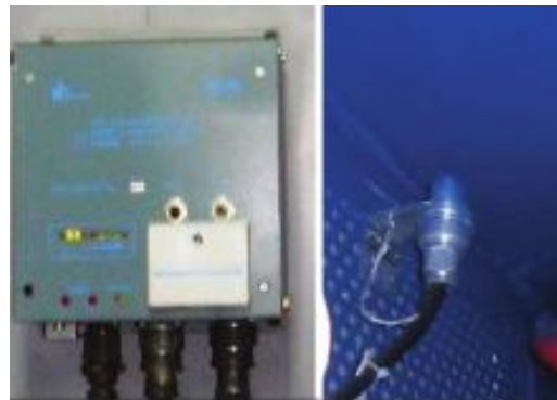
Рисунок 4 – Система газообнаружения компрессорных установок
