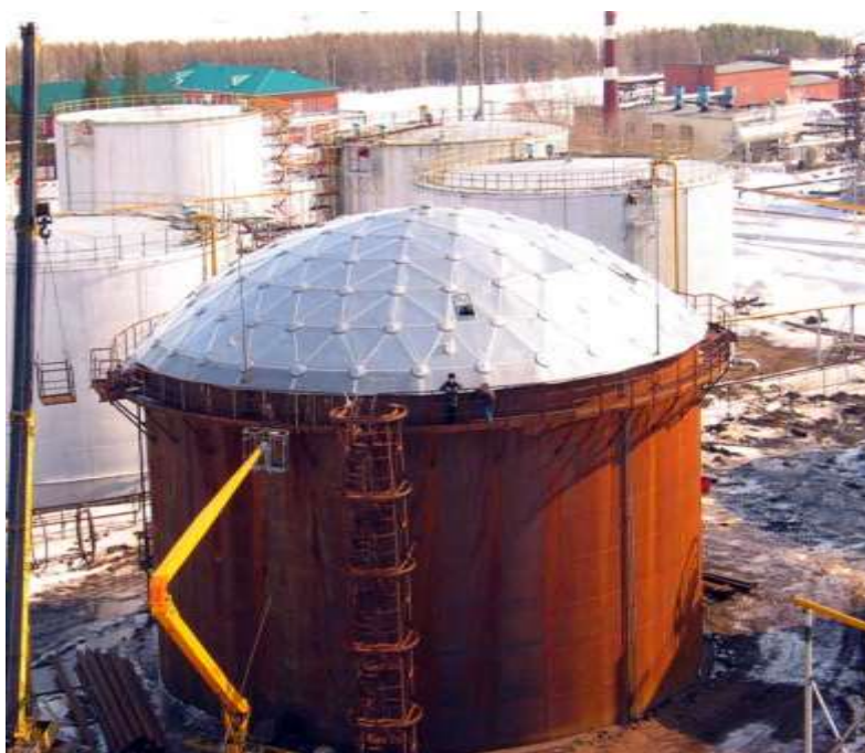
Рисунок 2.9 – Резервуар з плаваючою покрівлею
