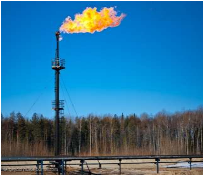
Рисунок 6.5 – Загальний вид факельної установки
