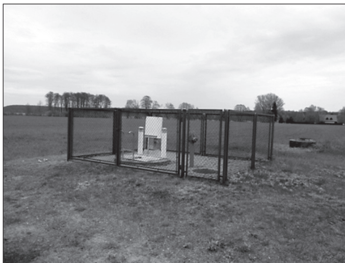
Fot. 8. Ujęcie wody w gminie Chojnice, miejscowość Małe Swornegacie
