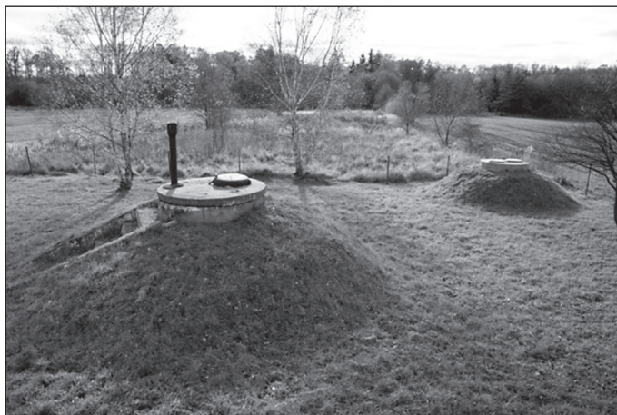
Fot. 1. Ujęcie wody podziemnej w Wilczkowie
