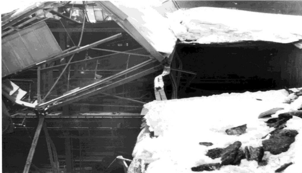
Рисунок 6.3 – Руйнування конструкцій покриття від снігового навантаження
