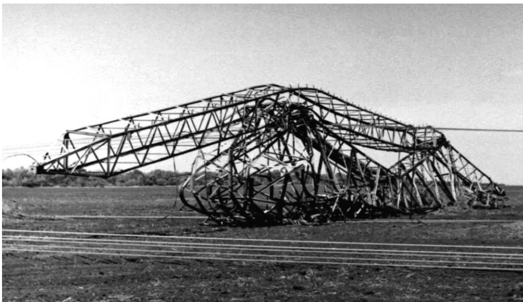
Рисунок 3.4 – Руйнування інженерної споруди від ожеледі
