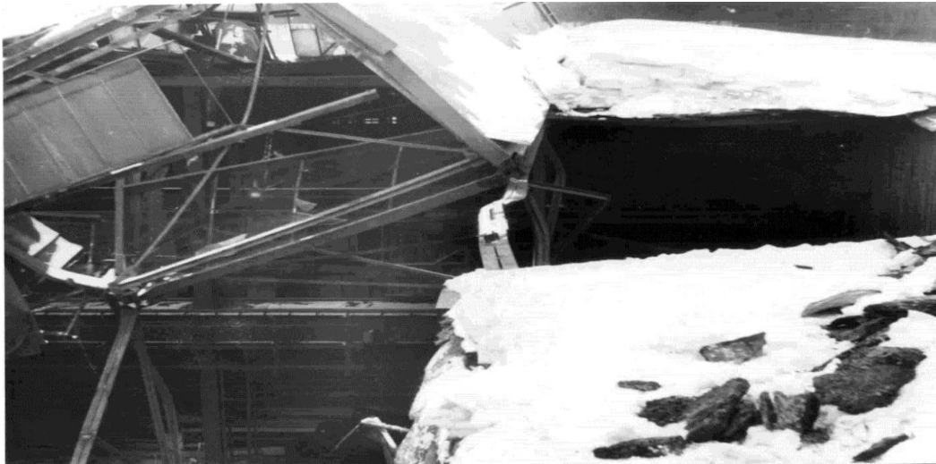
Рисунок 3.1 – Руйнування конструкцій покриття від снігового навантаження
