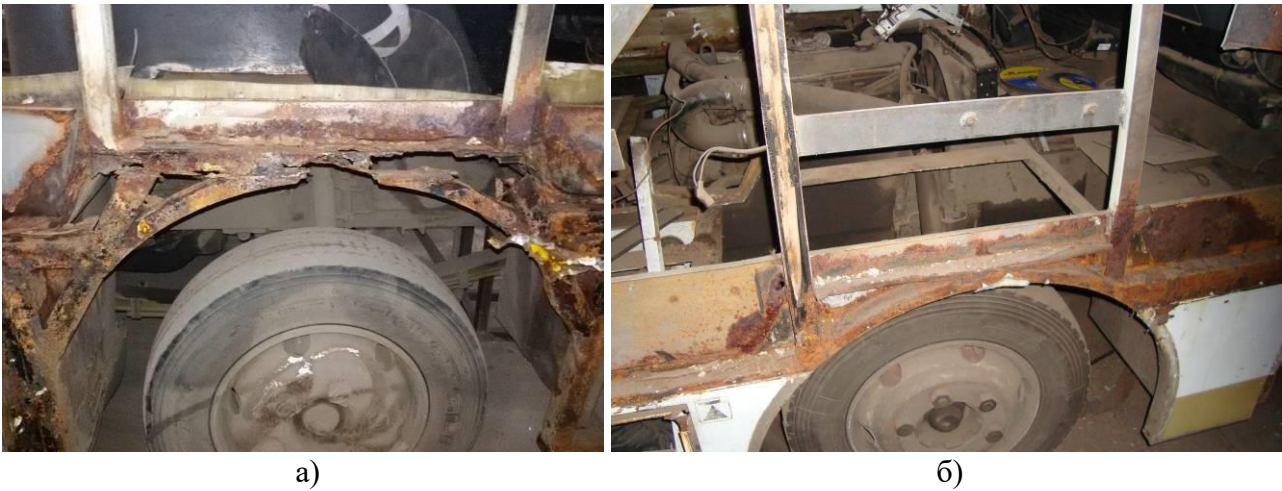
Рисунок 9 – Корозія правої боковини автобусів «Богдан А-092» біля переднього колеса: а) термін експлуатації 10 років; б) термін експлуатації 5 років
