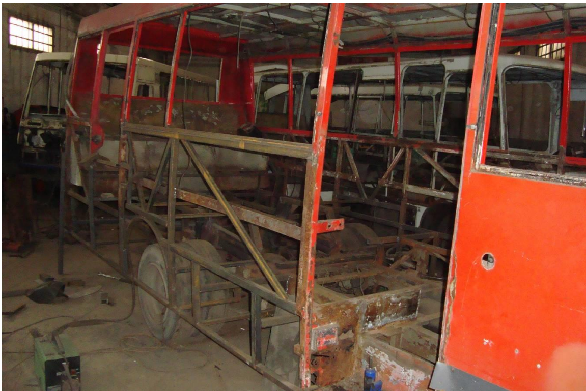
Рисунок 8 – Корозія каркасу автобуса «Богдан А-092», на якому частково відремонтована права боковина (термін експлуатації 9 років)
