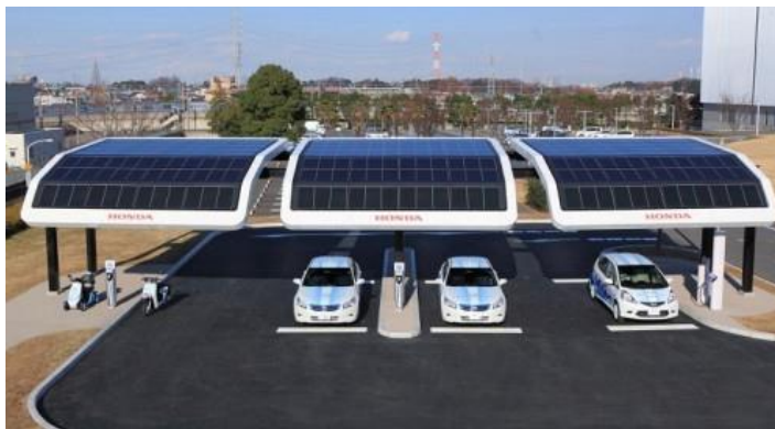
Рисунок 1 – Заправна станція компанії Honda для електро автомобілів і скутерів на сонячних батареях з системою накопичення енергії
