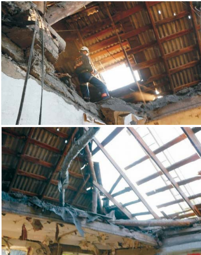
Наслідок пожежі у п'ятиповерховому житловому будинку із дерев'яним перекриттям та покриттям
