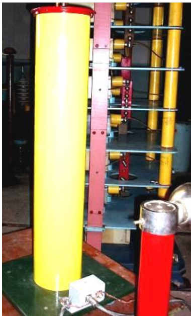
Рис. 7. Общий вид передвижного высоковольтного делителя импульсного напряжения типа ЕДН-100 на номинальное напряжение \pm 100 кВ, размещенного на испытательном поле сверхвысоковольтного генератора импульсных напряжений типа ГИН-1,2 этажерочной конструкции собственной разработки (генератор ГИН-1,2 размещен за делителем ЕДН-100; справа от делителя ЕДН-100 расположены передвижные стандартные измерительные шары диаметром 125 мм) [15]
