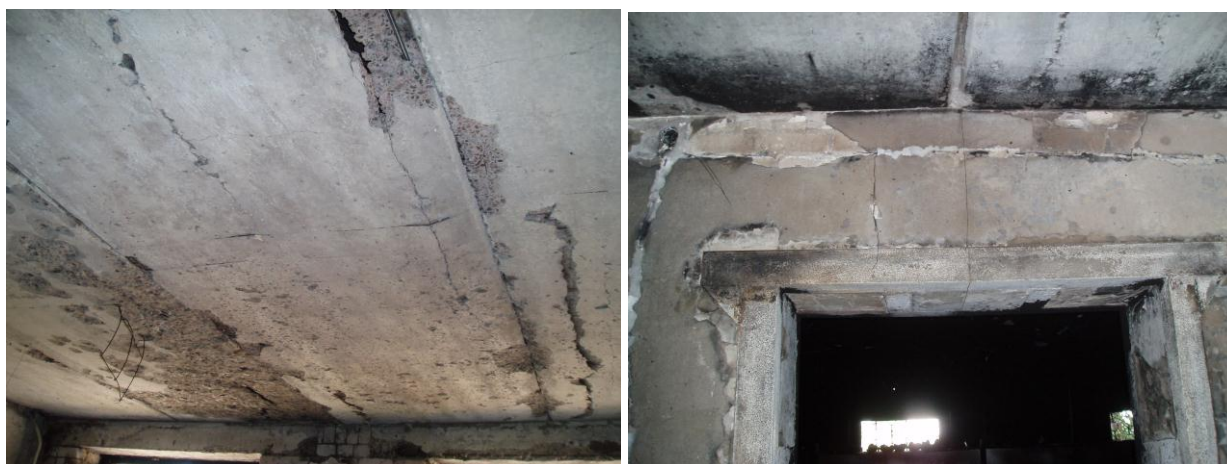
Рис. 2. Пошкоджені будівельні конструкції
