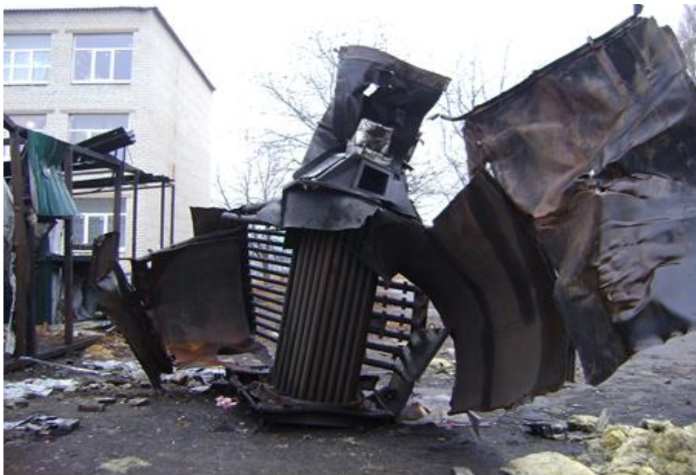
Рисунок 1 - Общий вид твердотопливного котла IGNIS-500 со следами разрушения теплообменной поверхности
