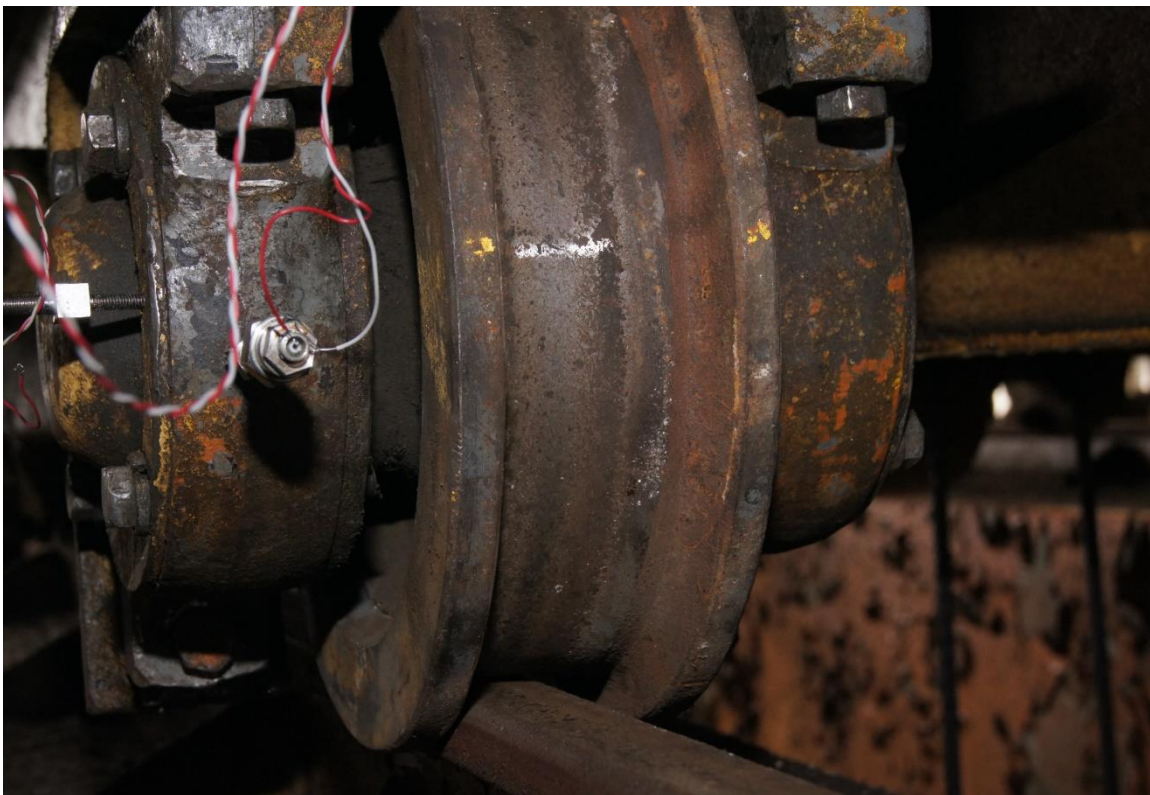
Рис. 5.8 Установка датчиків реєстрації шуму і вібрації на буксу штатного ходового колеса візка мостового крана
